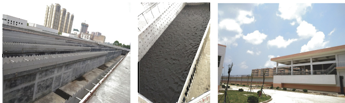
广西玉林市城北水厂 17万吨 翻板滤池
