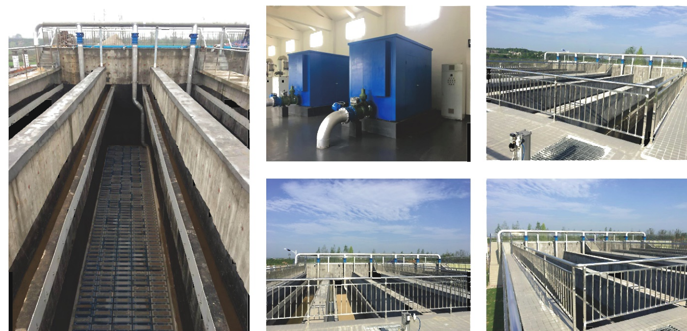
湖南湘潭第二污水处理厂 4万吨 反硝化深床滤池
