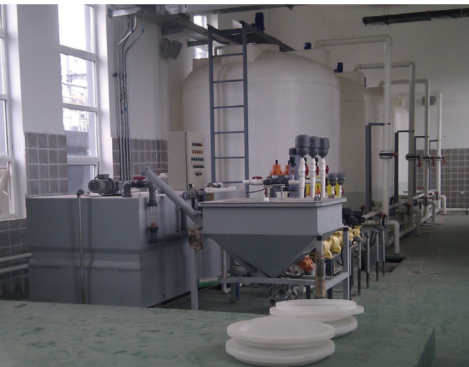
北京清河污水处理厂加药系统
