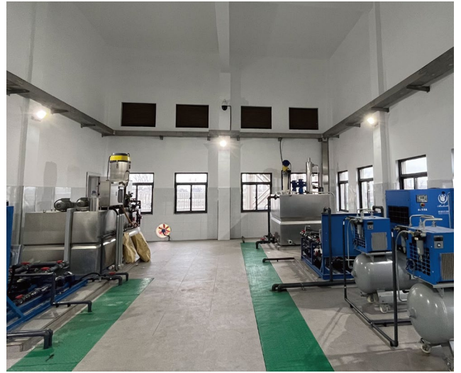
浙江衢州江山贺村污水处理厂
