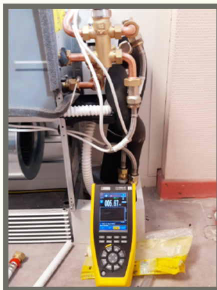
测量暖通空调系统：电流、电压及温度。
