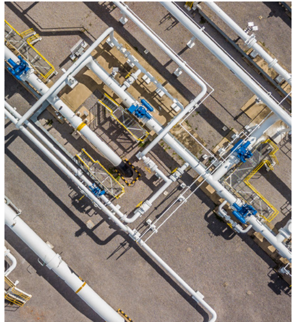
油气输送管道
