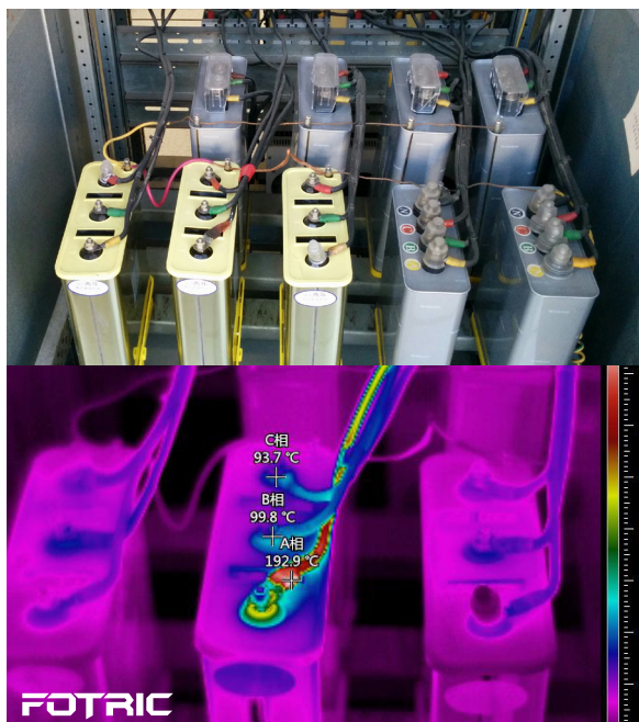
配电柜电容接头温度检测
