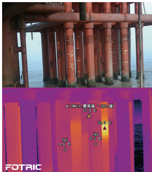
油井管套损坏
