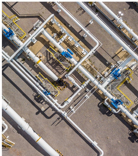
油气输送管道
