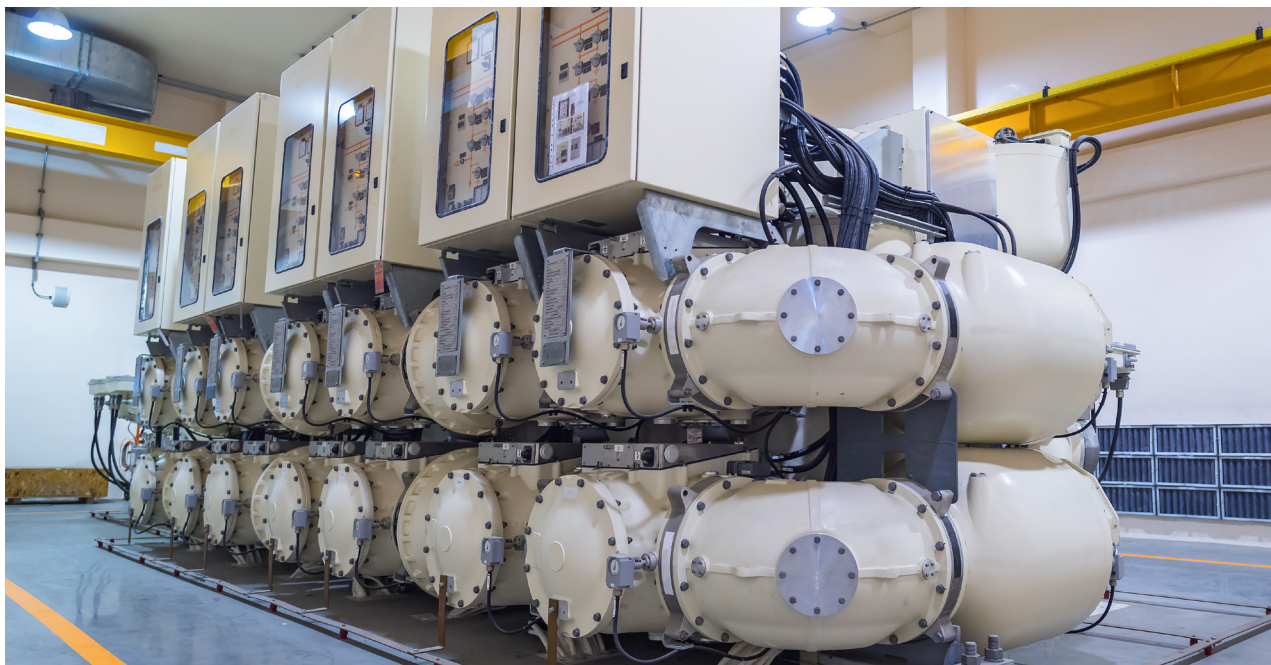
GIS高压开关柜
