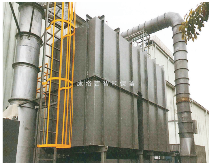
蓄热式焚烧炉RTO
