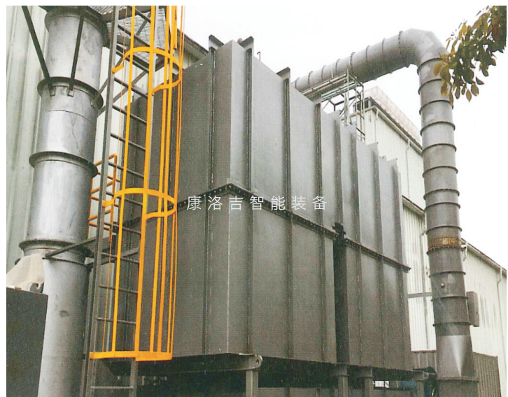
蓄热式焚烧炉RTO
