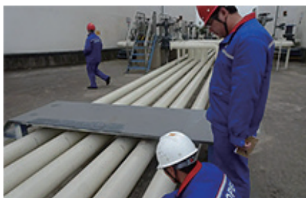
油气输送管道
